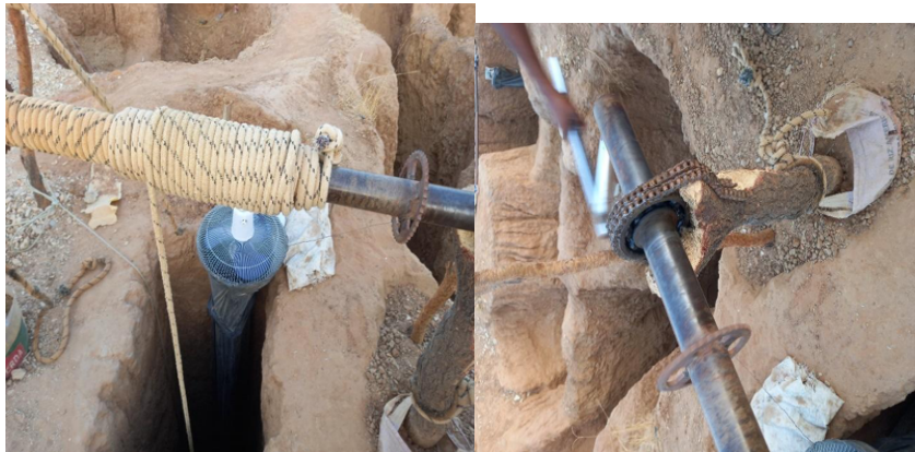
Photo 26: Système de ventilation artisanale des puits sur le site de Tadreyssa (Brakna)
